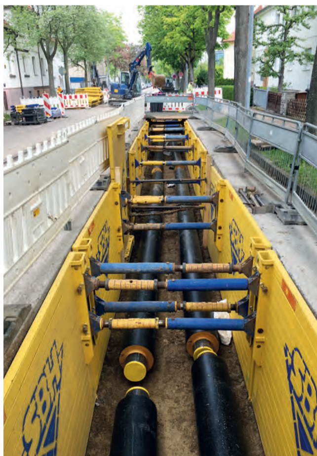
In Ludwigsburg sind für die Erweiterung des Fernwärmeverbundnetzes der SWLB Kunststoffmantelrohre, sogenannte KMR-Rohre, einfach verstärkt, DN 250/DA 450, zum Einsatz gekommen. (Foto: Schenek Tiefbau GmbH)
