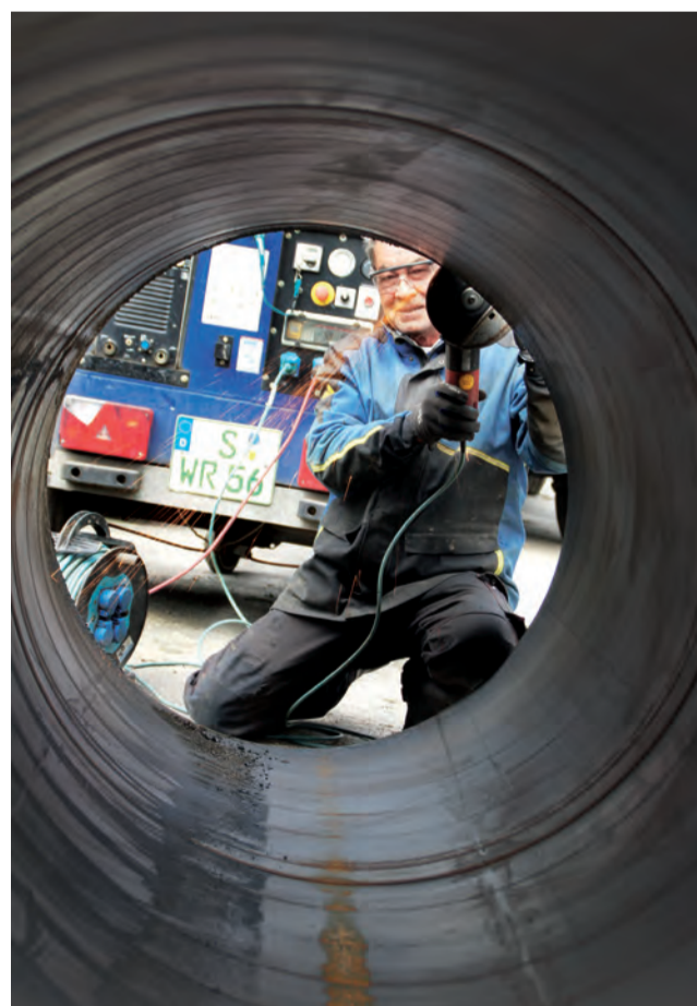
Das „Anfasen“: Der Monteur beim Schleifen und Vorbereiten eines Rohrendes für die Schweißnaht. (Foto: Stadtwerke Ludwigsburg-Kornwestheim GmbH, SWLB)
