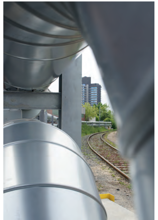
Ein Teil der neu zu erstellenden Fernwärmeleitung wurde parallel zu einer Industriebahnlinie aus dem Boden herausgeführt, aufgeständert, gesichert und mit Metallmantel isoliert. Die für dieses neben der Gleisanlage oberirdisch verlaufende Teilstück erforderlichen Bettungs- und Betonfundamentarbeiten wurden von der Schenek Tiefbau GmbH durchgeführt. (Foto: Stadtwerke Ludwigsburg-Kornwestheim GmbH, SWLB)
