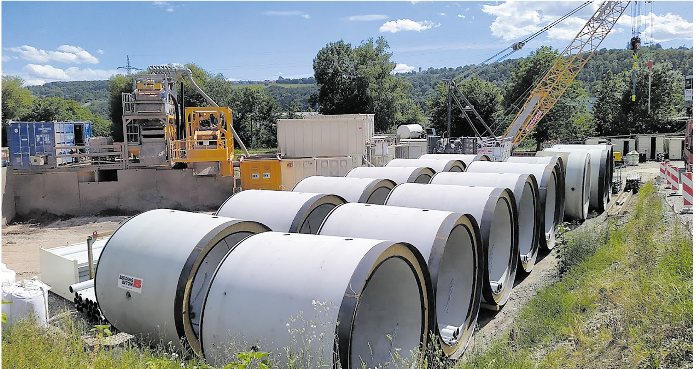
Aus diesen Stahlbetonrohren wird in den kommenden Wochen der Tunnel unter dem Fluss zusammen montiert.
